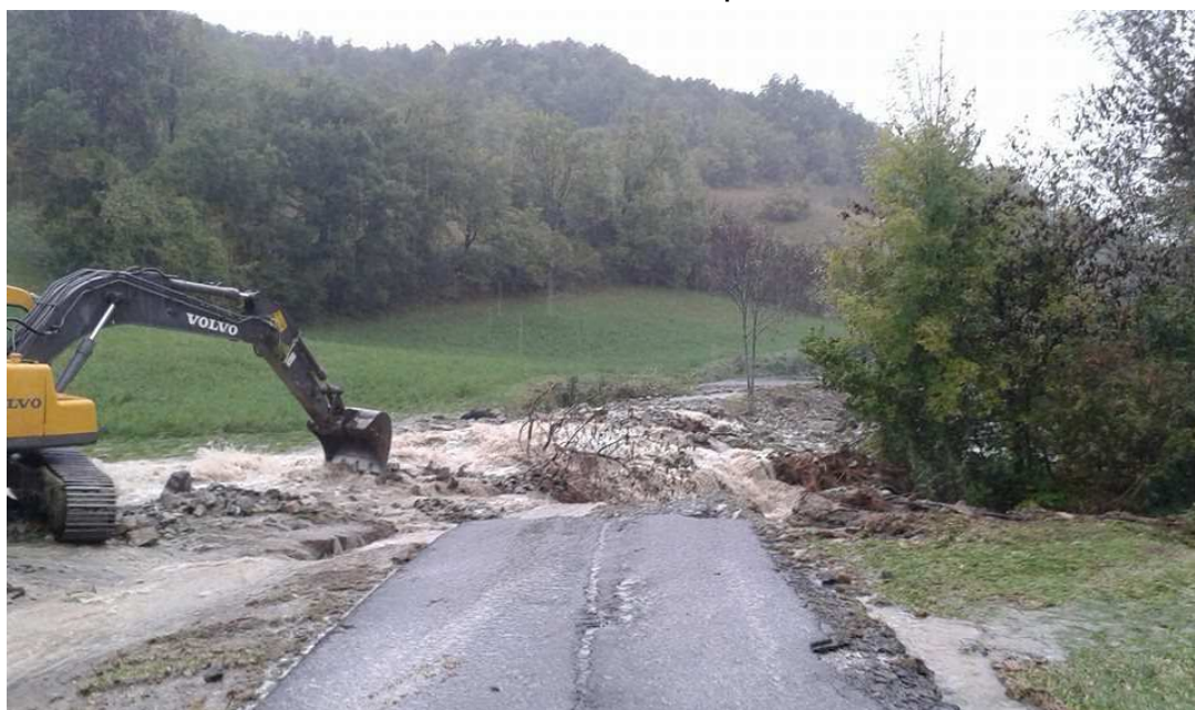
Frana nei pressi della frazione di Campagna , Farini - Foto a cura di Marco Gambazza
